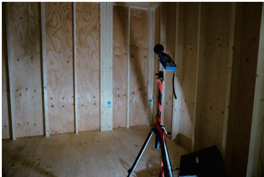
写真 89 スピーカマイク設置状況
