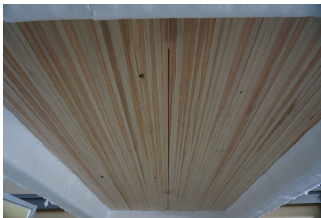
写真 47 試験体 裏面状況
