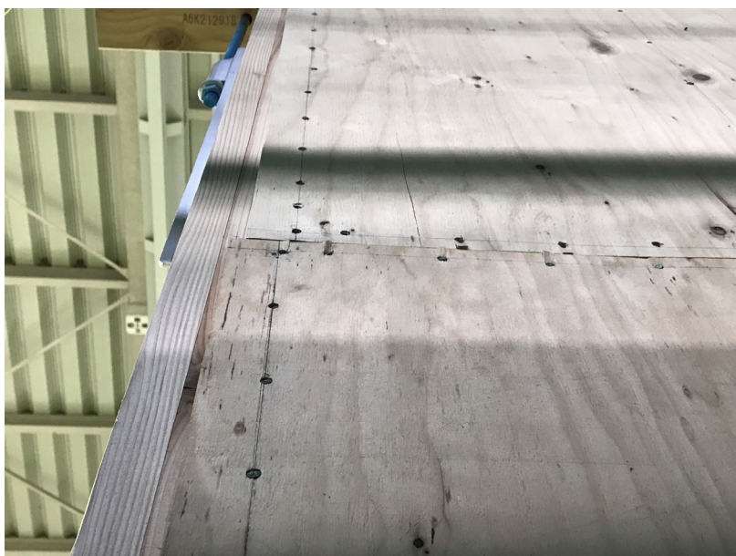
写真 27 試験体 B 終了時 合板固定部 破壊状況
